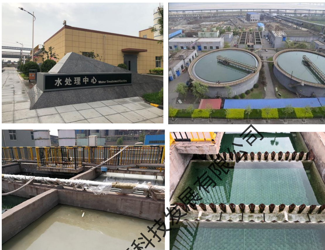
图 8.2-2 龙钢公司污水处理站现状图片
